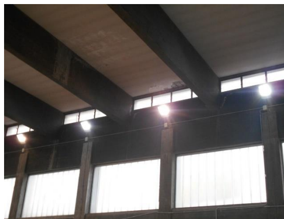
Figura 4.23 - Particolare dei corpi illuminanti ubicati nella palestra
