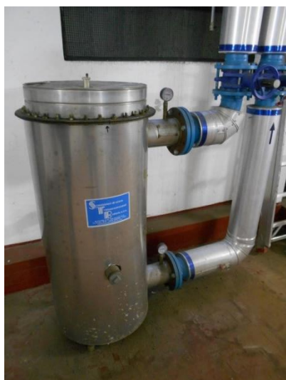
Figura 4.19 - Particolare dello scambiatore di calore per l’acqua calda sanitaria in centrale termica
