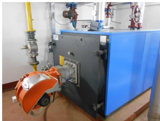
Figura 8.7 - Particolare dei generatori di calore
