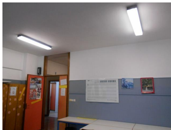
Figura 4.21 - Particolare dei corpi illuminanti ubicati nelle aule scolastiche
