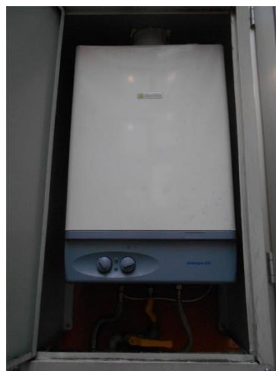
Figura 4.20 - Particolare della caldaia murale
