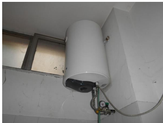
Figura 4.18 - Particolare di un boiler elettrico per la produzione di acqua calda sanitaria
