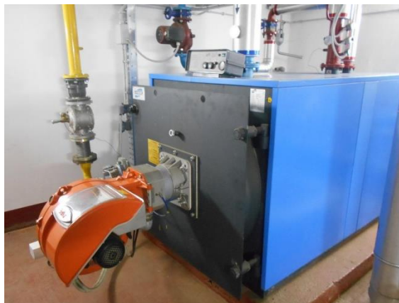
Figura 4.17 - Particolare della caldaia a basamento
