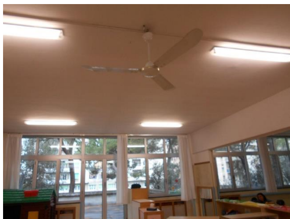
Figura 4.22 - Particolare dei corpi illuminanti e di un ventilatore ubicati nell’asilo nido
